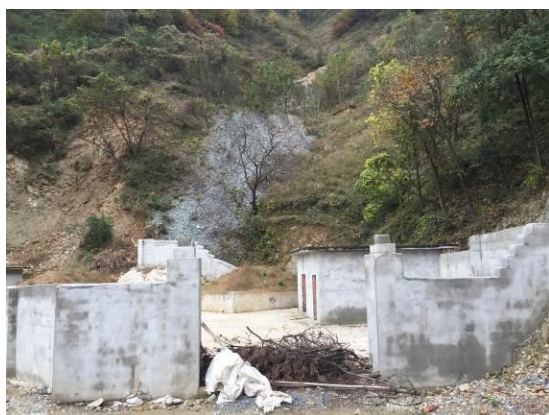
照片 3-16 设施建设破坏地形地貌
