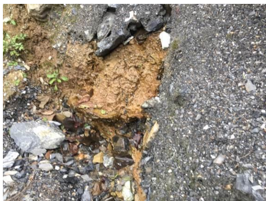
照片 3-12 坡体流水
