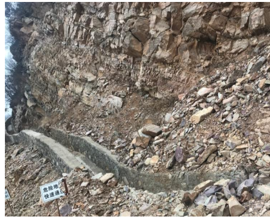
图 2-29 尾矿库道路排水渠
