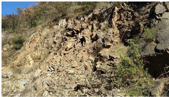
照片 3.2-1 崩塌全貌（镜向 NW）
