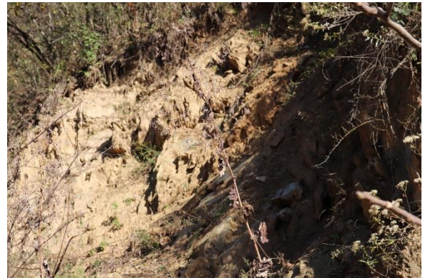
照片 3.2-4 滑坡 HP1 局部（镜向 NE）
