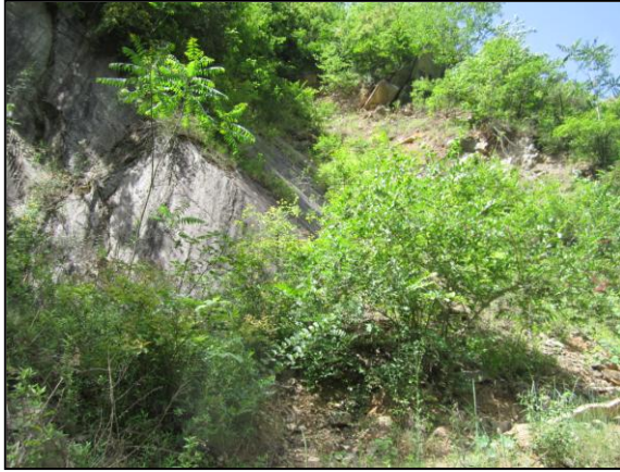
照片 3-1 崩塌隐患 BT1 (镜向 225°)
