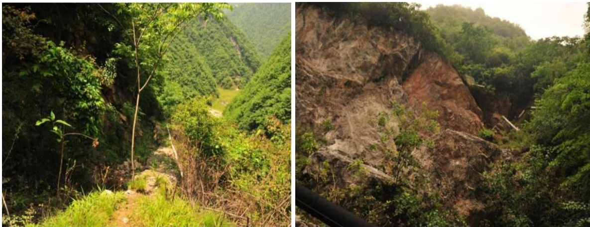
照片 2-33 小东沟废石场南截排水沟(镜向 280°) 照片 2-34 地面塌陷区排水设施(镜向 75°)
