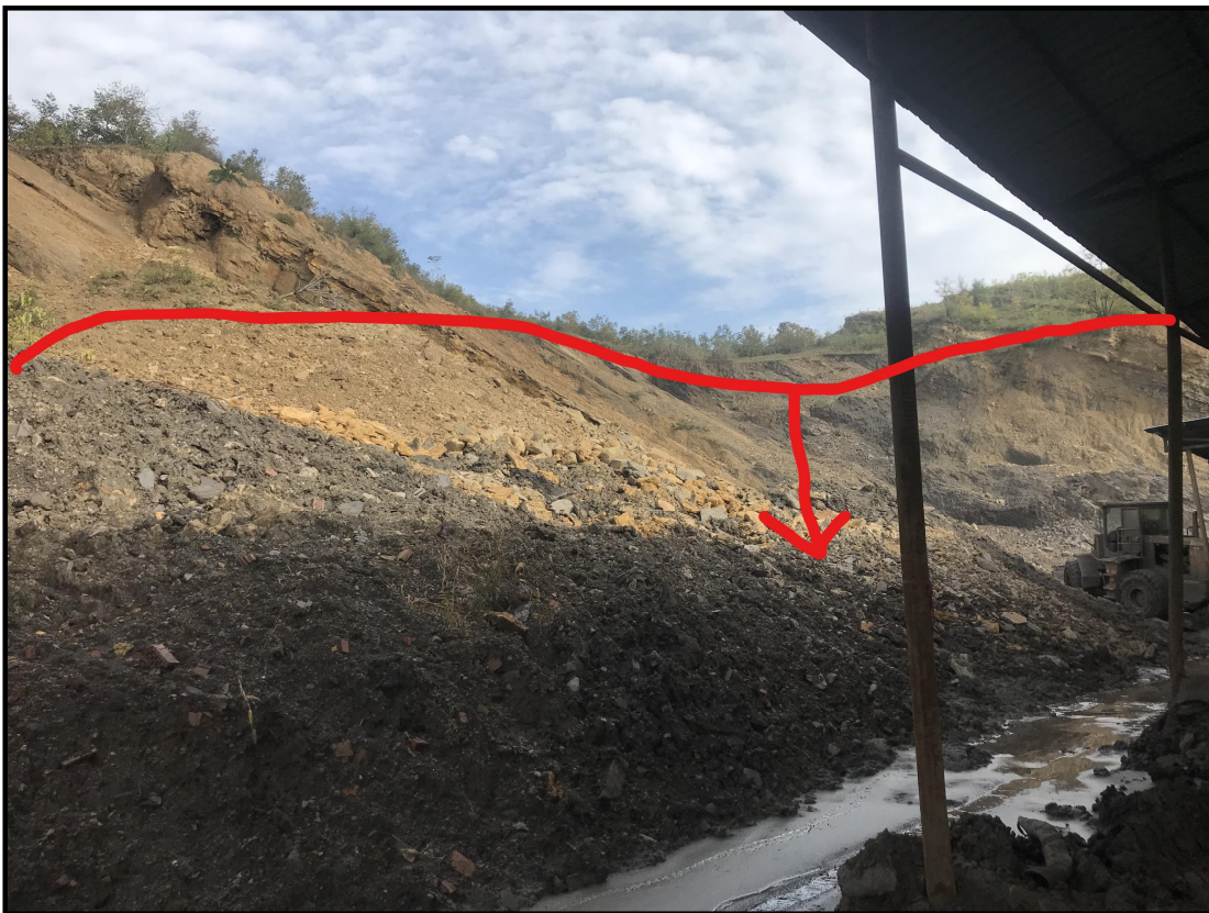
照片 3-1 B1 崩塌（工业场地北侧）（镜向 30°）
