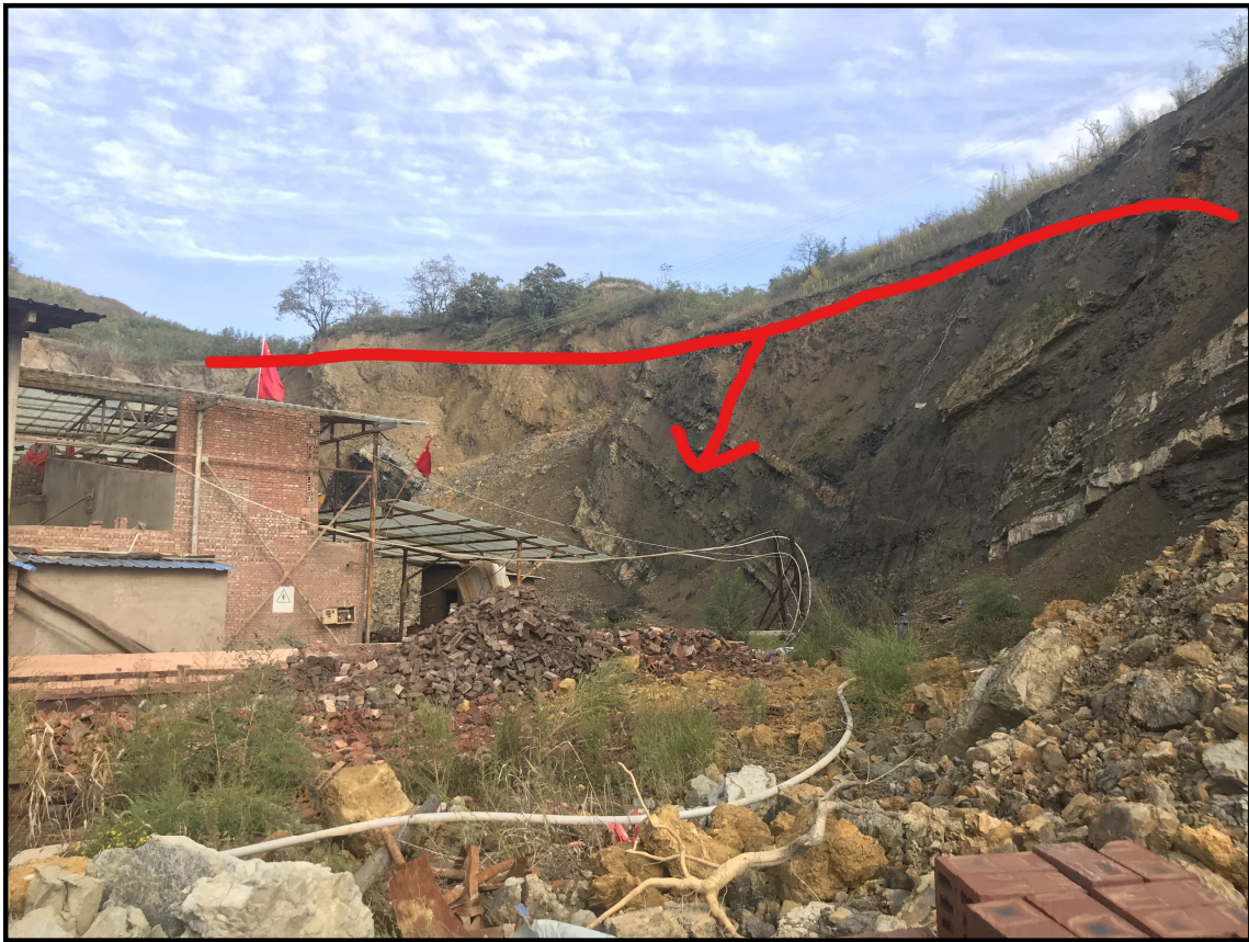
照片 3-2 B1 崩塌（工业场地东侧）（镜向 35°）
