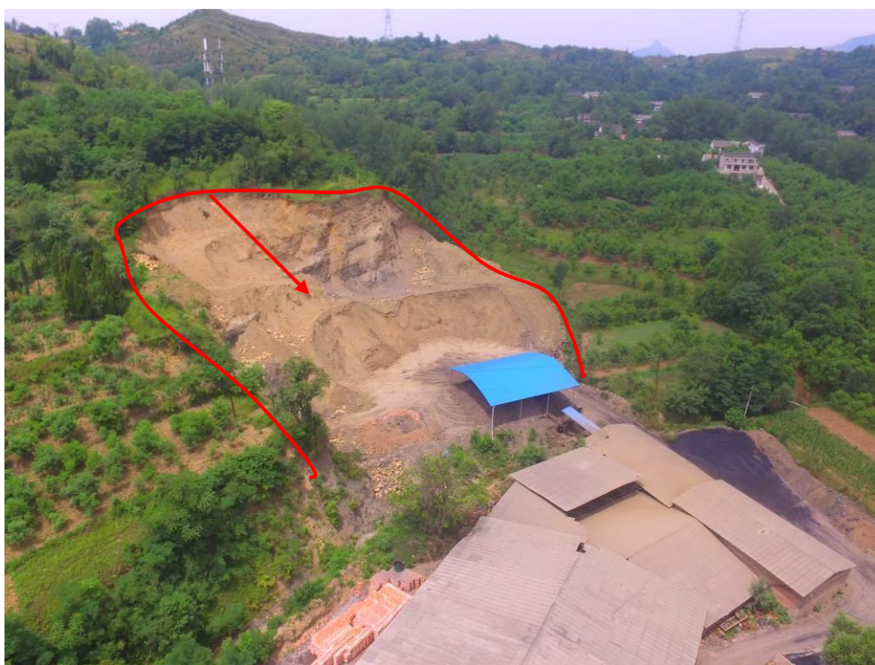
照片 3-1 H1 滑坡隐患
