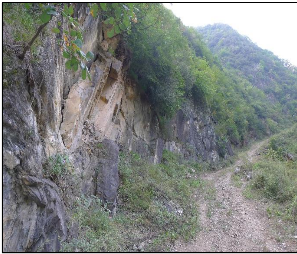
照 3-3 B01 崩塌现状（镜像北）
