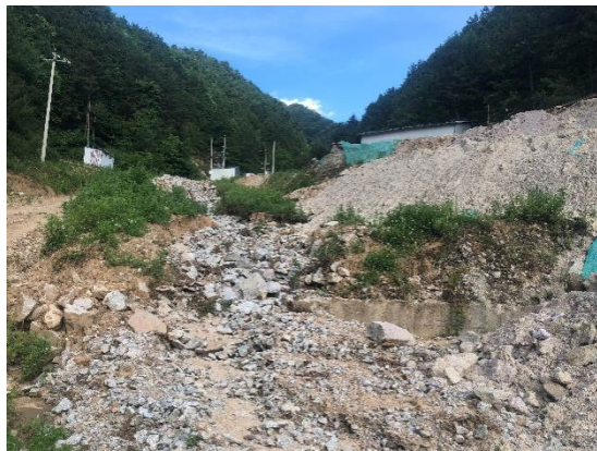
照片 3-4 N1 泥石流隐患点
