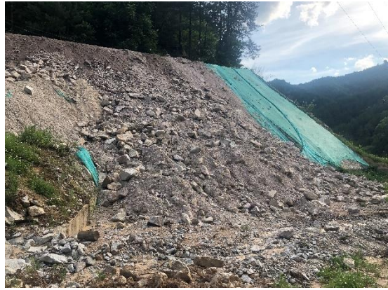
照片 3-3 N1 泥石流隐患点
