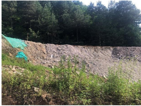
照片 3-2 N1 泥石流隐患点
