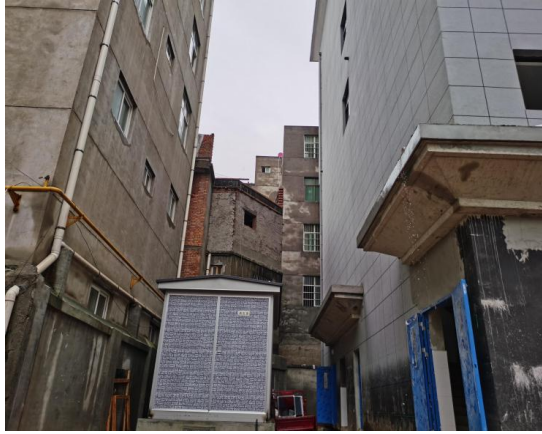
后勤楼南侧高压室
